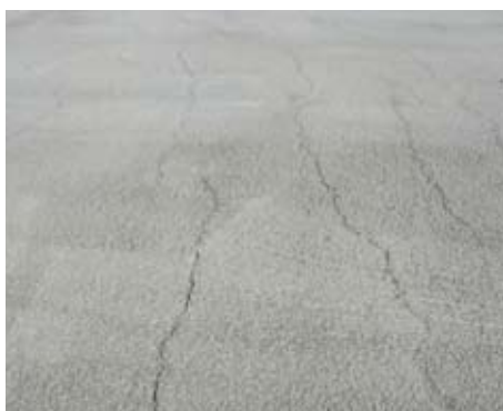
Betongyta där vattnet har fått avgå för snabbt från betongmassan så att det har uppstått mängder av plastiska krympsprickor.
